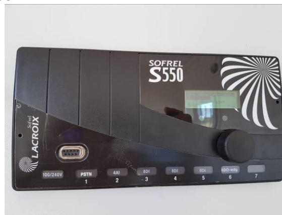
Armoire de commande (Automate SOFREL)
