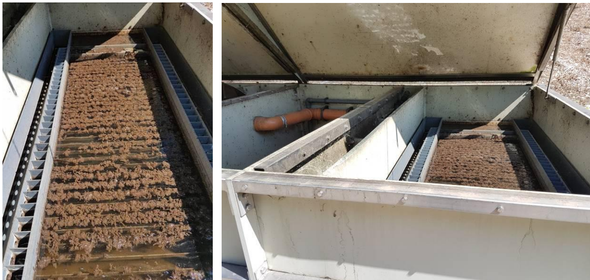
Vue du décanteur lamellaire
