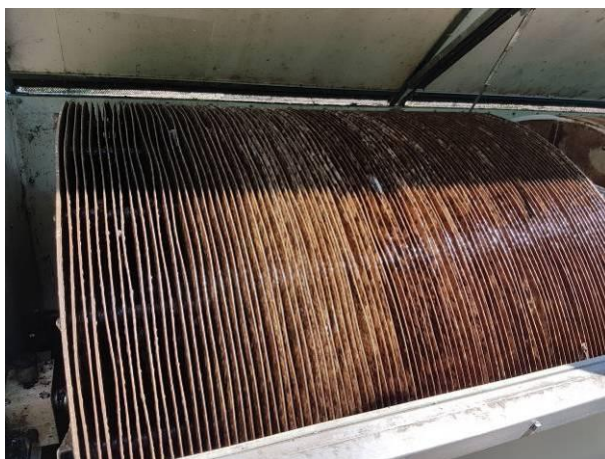
Vue intérieure des biodisques
