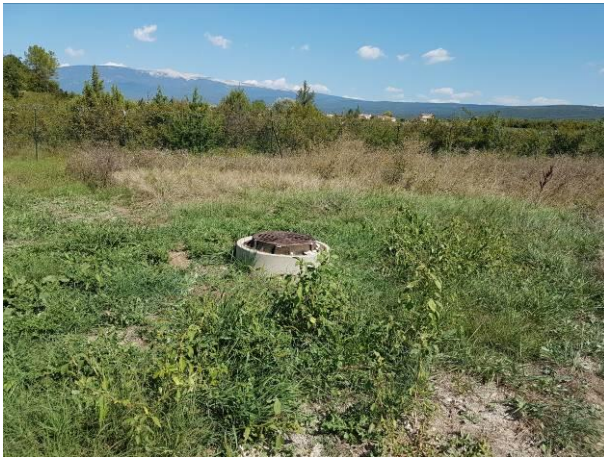
Regard de la canalisation existante de rejet des eaux traitées
