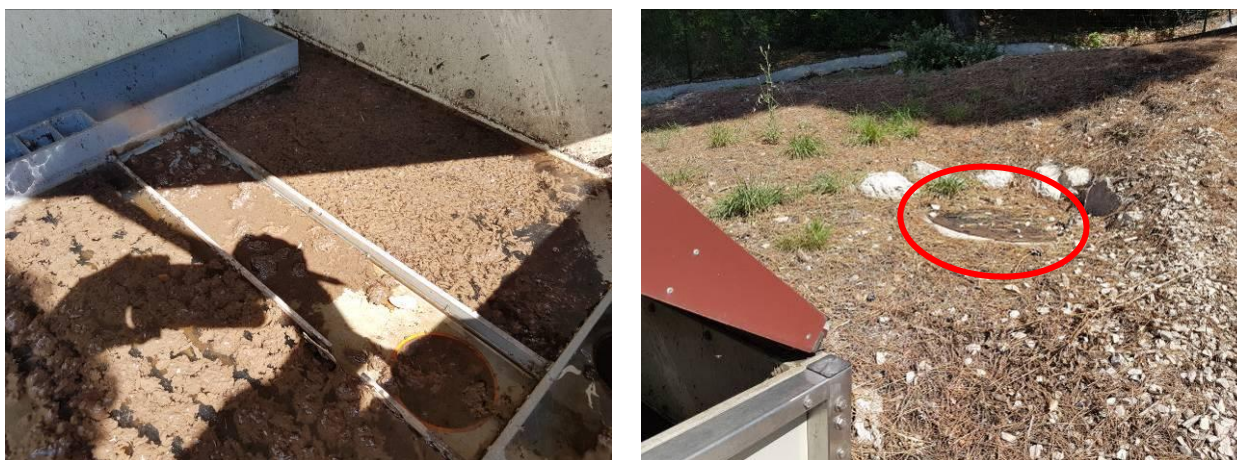
Vue de Goulotte de d'évacuation des flottants et la buse de récupération
