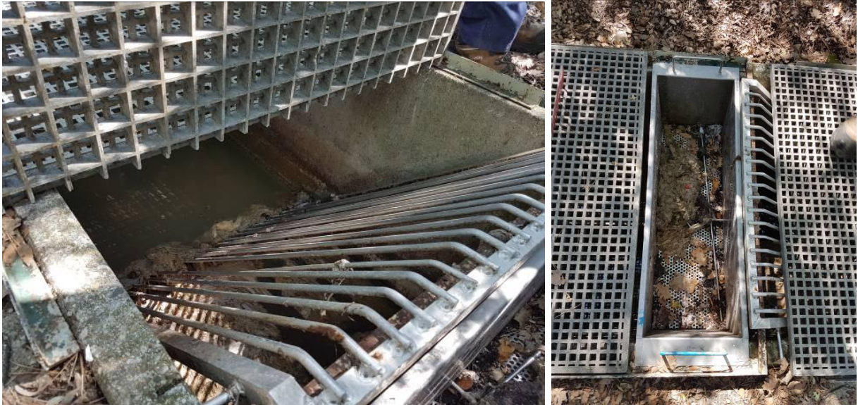
Vue du dégrilleur et du panier d'égouttage
