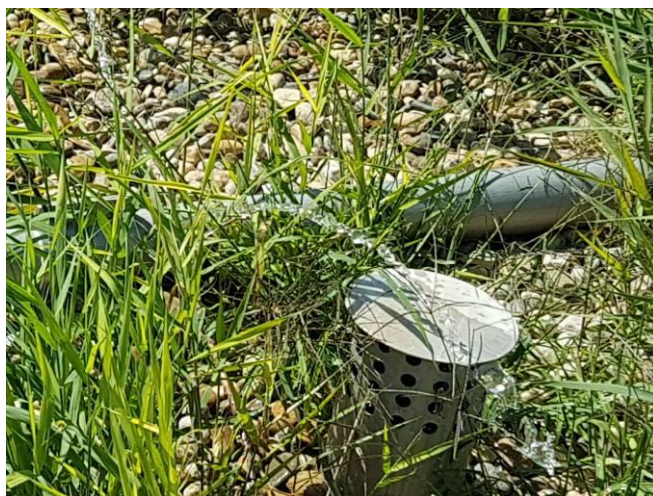
Jet arrivant dans une des cheminées
