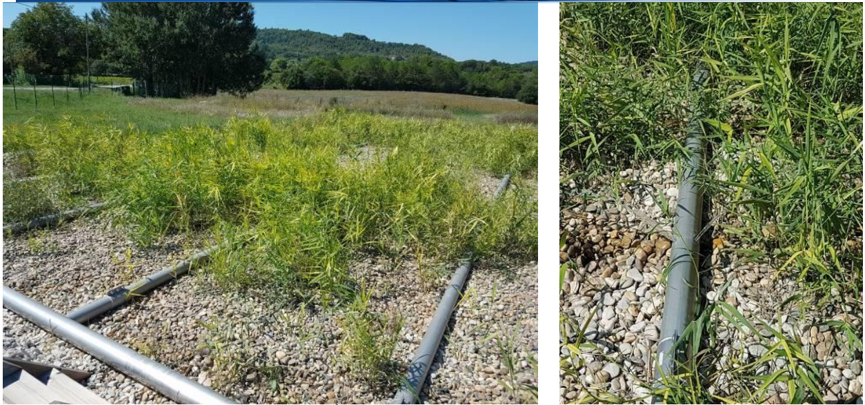
2 nd étage de filtre planté de roseaux
