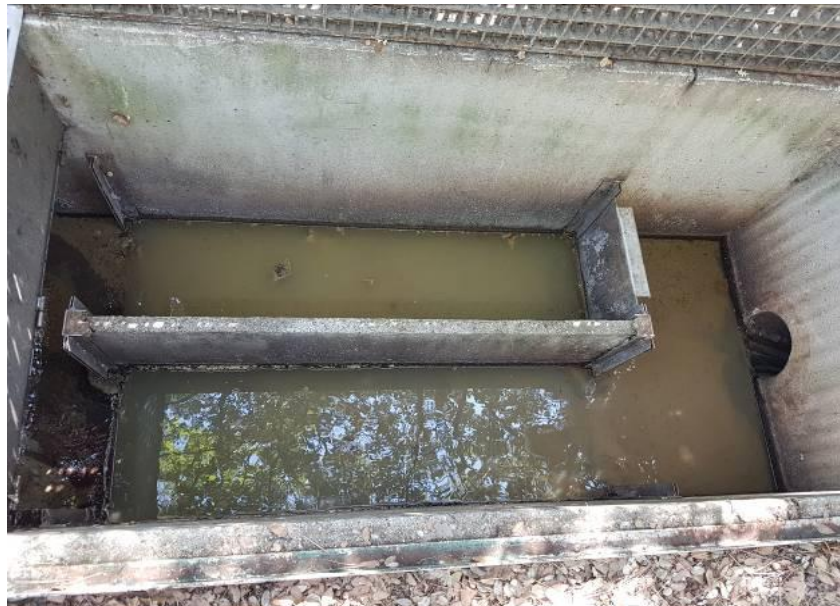
Vue du système de dessablage
