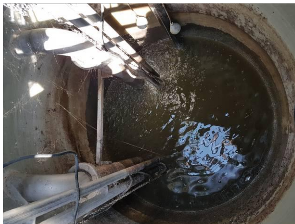
2 nd poste de relèvement
